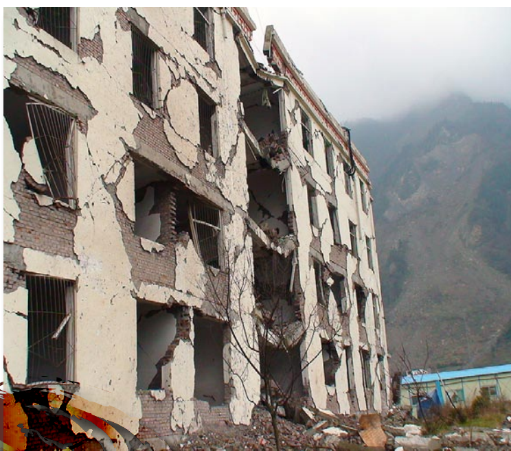
École touchée par le tremblement de terre du Wenchuan
